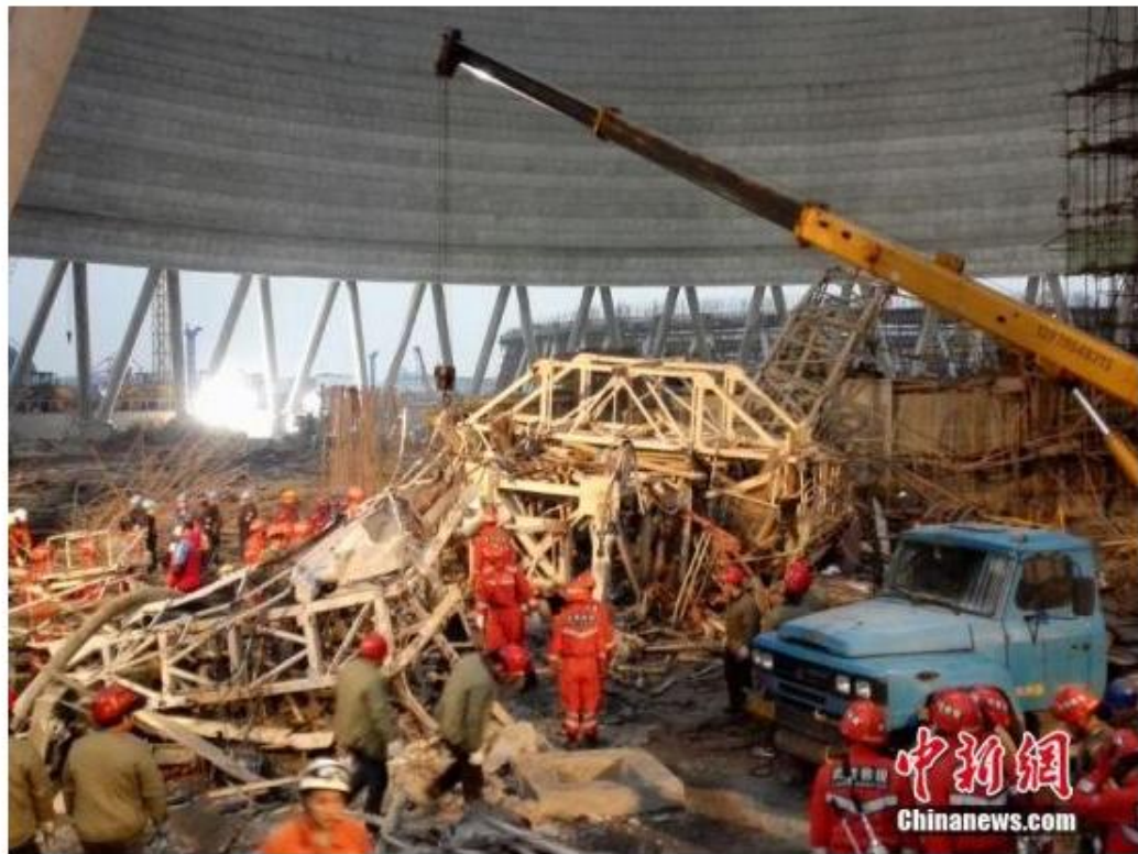
资料图 江西宜春丰城电厂在建工地发生坍塌 刘占昆 摄
